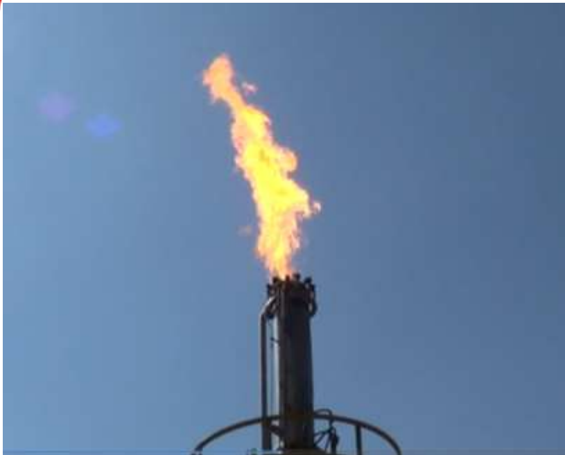
Flare de testes da Asvotec (condição smokeless*).
