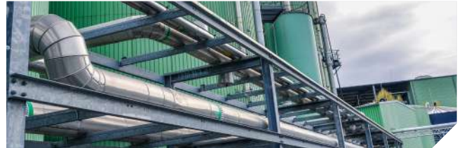
Equipamentos diversos para plantas de Biogás e biometano / Equipment for Biogas and Biomethane plants.
